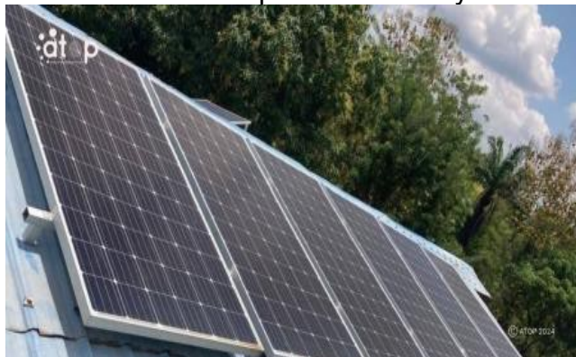
Panneaux solaires nettoyés
