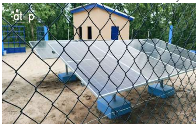
Une station de pompage photovoltaïque
