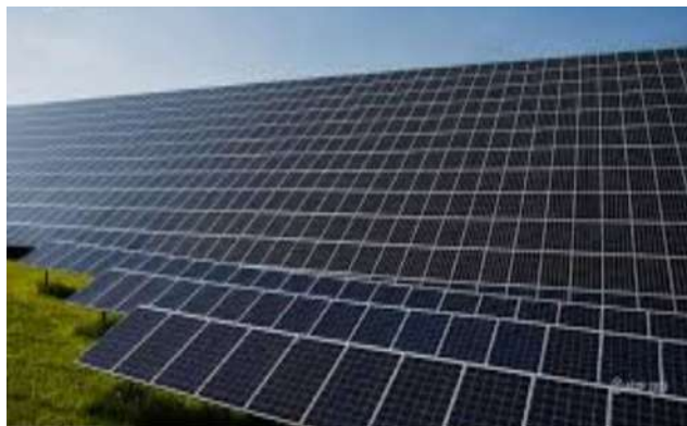
Les plaques de la centrale solaire de Blitta
