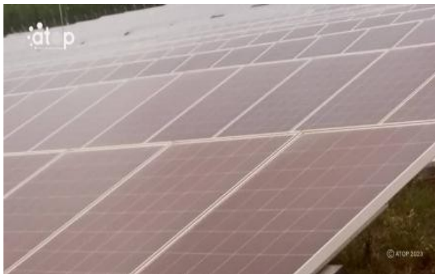
Vue partielle des panneaux de la centrale solaire de Blitta
